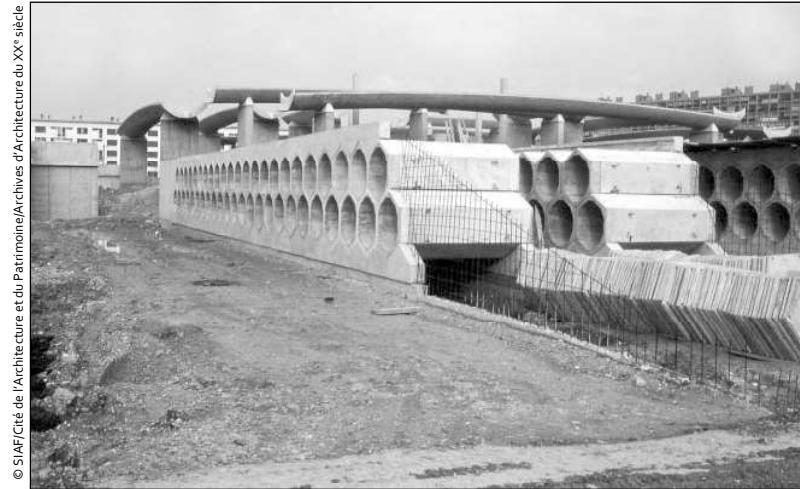
Vue des enfeus en cours de réalisation (cliché de R. Auzelle du 21 mars 1974)
