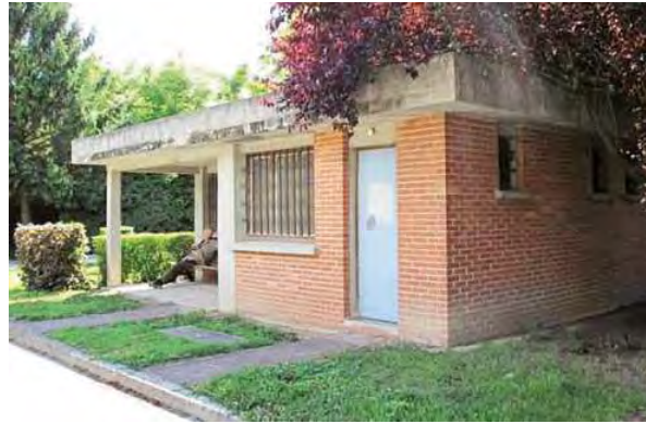
Abri sanitaire : démolition à envisager
