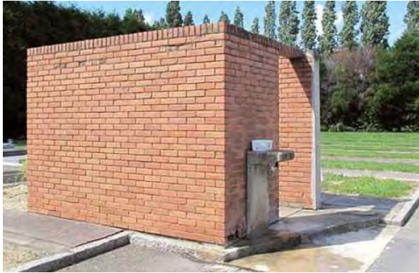
Exemple de local déchets : démolition à envisager
