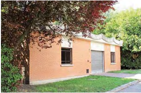
Ancien four : démolition à envisager
